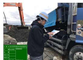
自重計による確認
